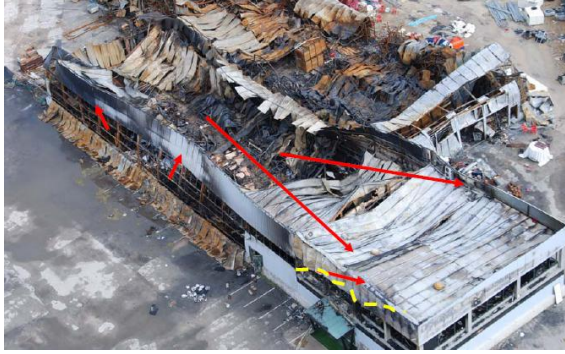
Caída de la cubierta de la Nave 2
