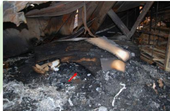
Oquedades y calcinación en el foco 2
