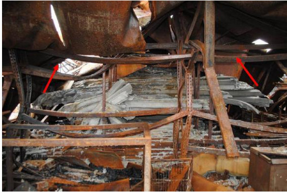
Afectación en los materiales de la nave 1
