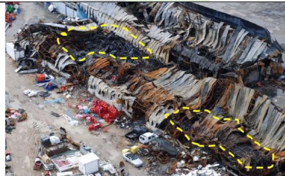
Zonas de afectación nave 1
