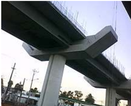
Jácenas de concreto cerca de la estación Olivos en 2010. El accidente se debió al colapso de una viga similar
