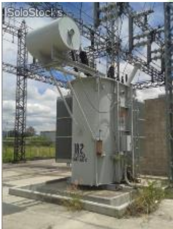
Subestación de Distribución de 5000 kva - 115 kv / 13,8 kv Trifásico
